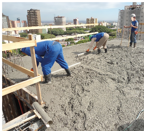
Figura 3.4 – Sistema de guarda-corpo e rodapés e linha de vida ineficazes em locais de realização de serviços em altura
