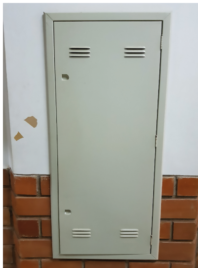
Figura 4.5 – Quadro de distribuição fechado
