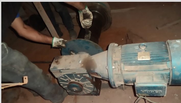
Figura 4.34 – Motor do Elevador
