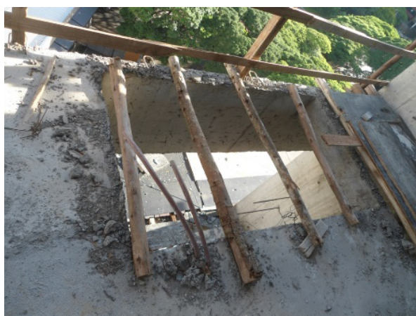
Figura 3.2 – Fechamento provisório incompleto de um vão em pavimento
