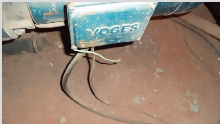
Figura 4.35 – Fio terra do motor do elevador
