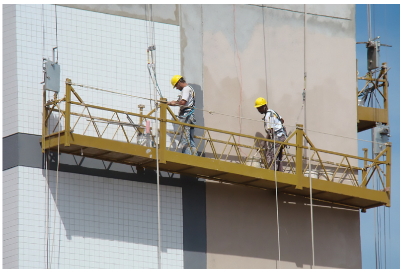
Figura 3.42 – Linha de vida vertical para fixação de cinto de funcionários na realização de trabalhos em fachada de edificação sobre andamento suspenso (balancim)
