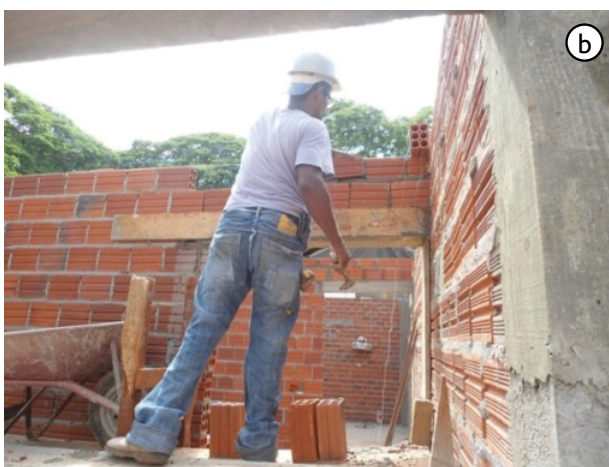
Ausência de complemento para andaime
