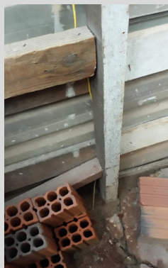
Figura 4.33 – Aterramento da obra
