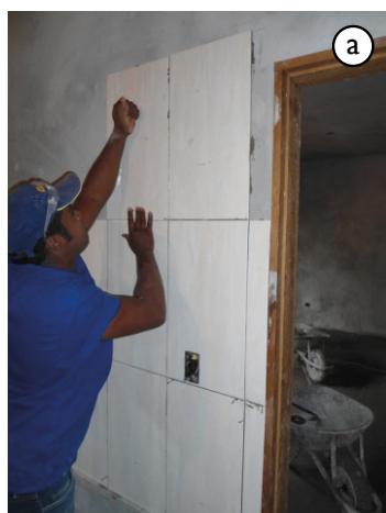
Falta de andaime
