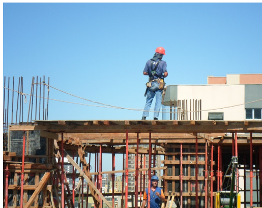
Figura 3.3 – Linha de vida inadequada para ancoragem de cinto de segurança
